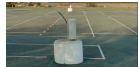
Supports coffret en béton
