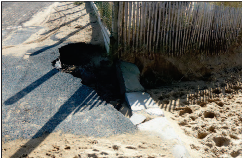
Erosion dunaire suite à imperméabilisation du sol
